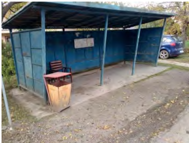
Autobusová zástavka v Kolačine pred rekonštrukciou...
